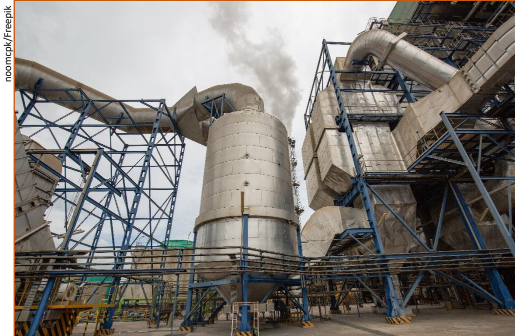
Usina de biomassa
